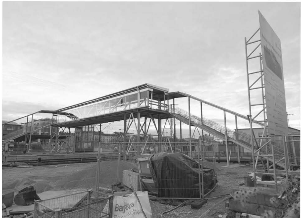
Wer Treppen gehen kann und keinen Kinderwagen dabei hat, ist hier im Vorteil: Überirdischer Behelfszugang von der Friedenstraße zu den Gleisen 13 und 14 (siehe BA-Artikel auf den Seiten 2 und 4)
