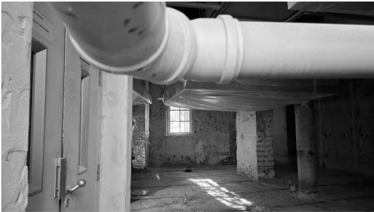
Nach dem Wasserschaden entkernt – die ehemalige Küche im Unionsbräu
