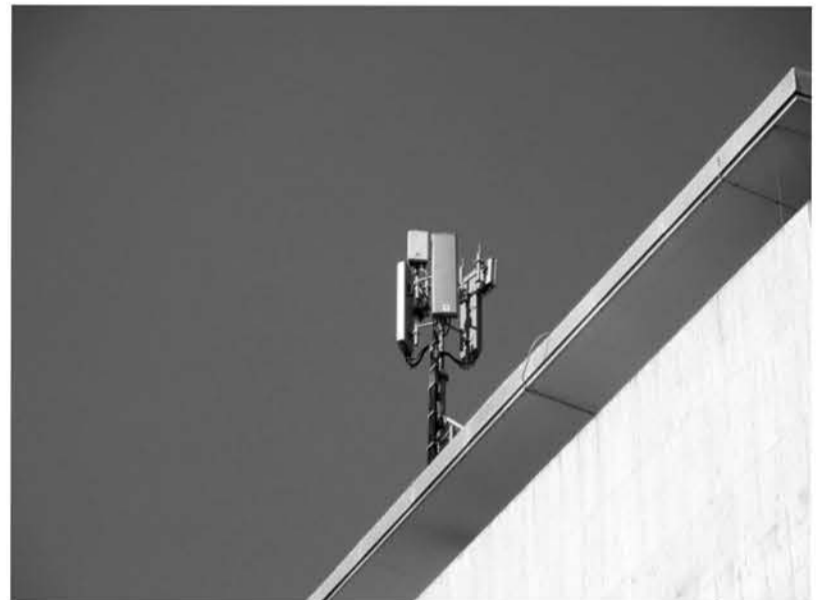
Die Telekom plant einen neuen Mobilfunkmast im „Suchgebiet Ostbahnhof-Nord“. Der Mobilfunkdienstleister „Vodafone“ will die bestehende Sendeantenne Asamstraße 26 technisch um 5G-System erweitern.
